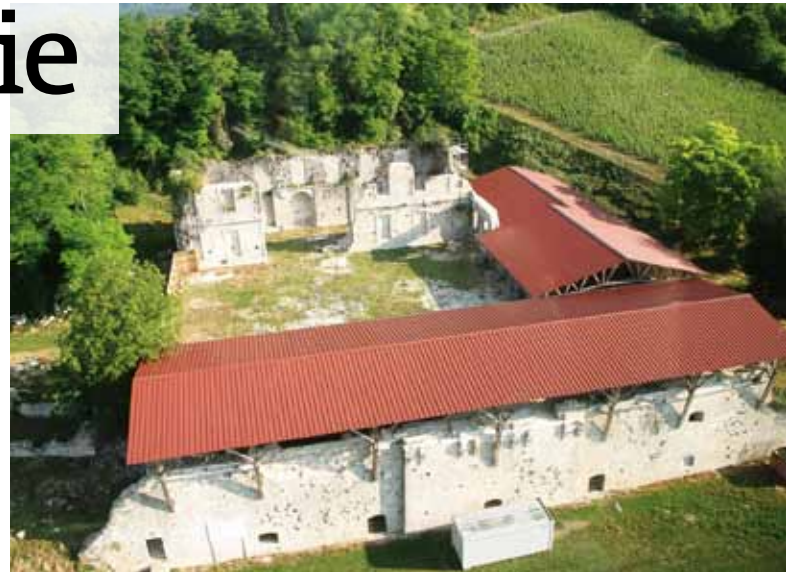
UN TOIT PROVISOIRE a été installé au début de la rénovation pour éviter que les bâtiments continuent à se dégrader. © ASSOCIATION SAINT VIVANT
